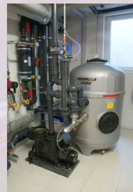
Desinfección UV de agua de piscinas
