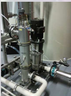
Desinfección UV de aguas de proceso
