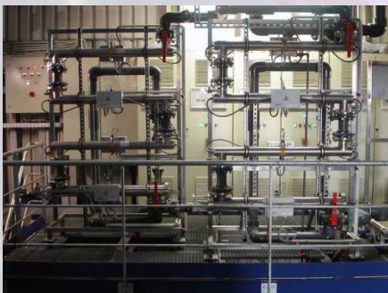
Tratamiento UV en planta depuradora de agua para la reducción de CSB en el muelle de Hamburgo, Alemania
