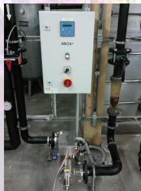
Tratamiento UV de agua de piscinas
