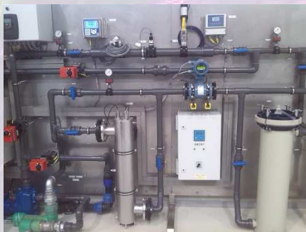
Desinfección UV de aguas de proceso
