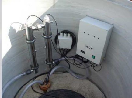
Desinfección UV de aguas residuales
