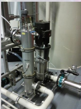
UV Desinfektion von Prozesswasser
