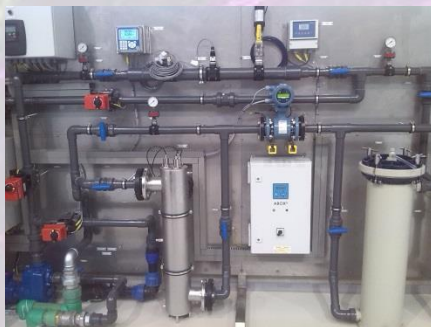
UV Desinfektion von Prozesswasser
