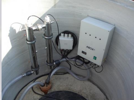
UV Entkeimung von Abwasser
