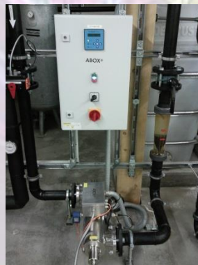
UV Behandlung von Schwimmbadwasser
