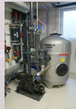
UV Entkeimung von Schwimmbadwasser
